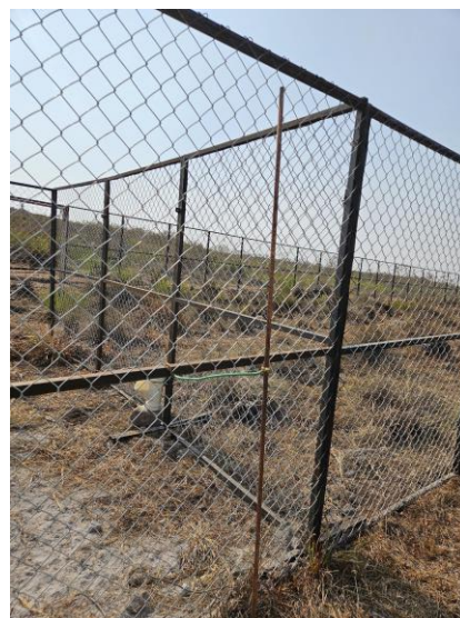
Aterramento realizado no viveiro
